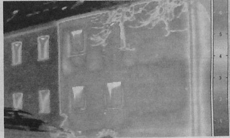
Bei der Thermografie-Aktion werden Schwachstellen an der Hausfassade sichtbar.
