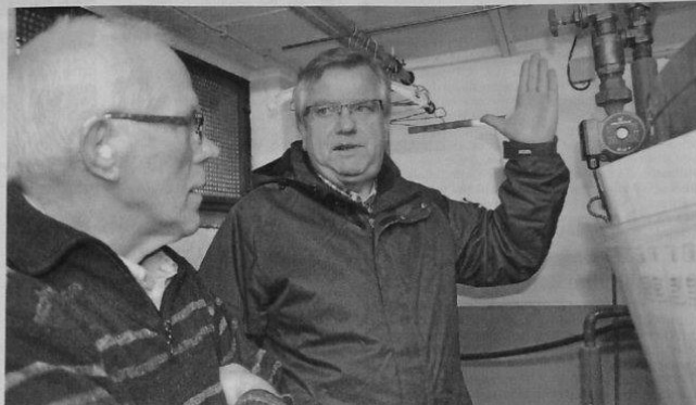
Rudolf Wendinger (links) lässt sich von Energieberater Thomas Venhorst erklären, was er an der Heizungsanlage austauschen lassen kann. Foto: Claudia Feld
