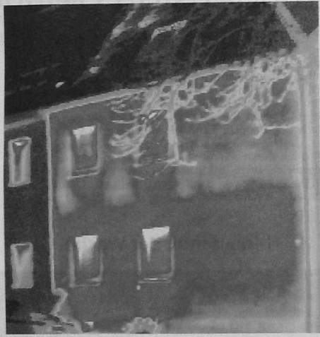
Bei der Thermografie deckt eine Wärmebildkamera Schwachstellen in der Dämmung deutlich auf. Foto: pd
